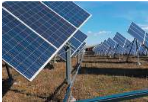
Fig. 1.13. Parcul fotovoltaic din orașul Ungheni
